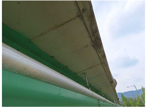
바닥관하면 S6 외측 캔틸레버 상태현황
