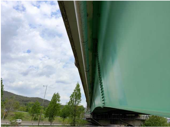
바닥관하면 S3 외측 캔틸레버 상태현황
